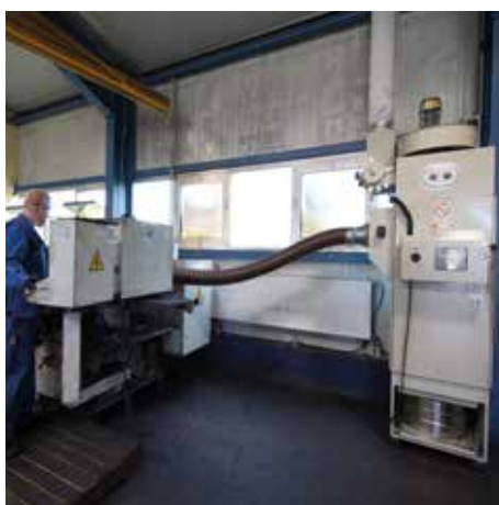
DS 63000 w obróbce metali
